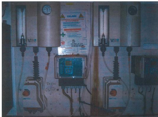
Figure 11 : Analyseurs de chlore en ligne au niveau de l'injection de chlore avant l'arrivée dans les réservoirs
