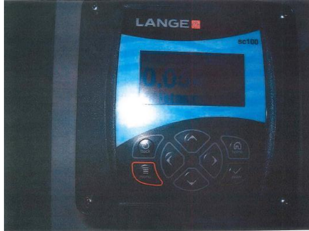
Figure 10 : Turbidimètre en ligne des eaux brutes de forage
