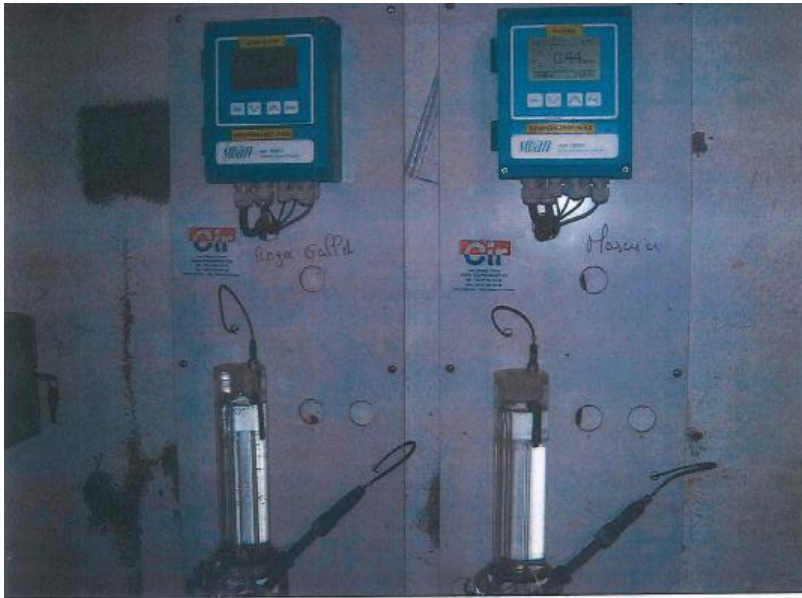
Figure 12 : Analyseurs de chlore en ligne en sortie des réservoirs
