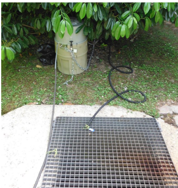
Figure 3: Préleveur automatique - station rejet.
